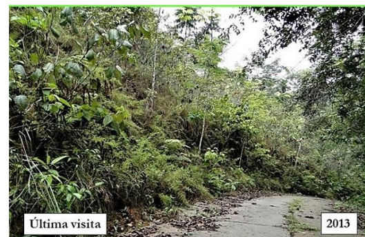
Figura 8 – Rehabilitación de un talud con fuerte pendiente, en el bloque 2 de la mina de bauxita de Los Pijiguaos, con potencial riesgo de caída de peñascos luego de precipitaciones fuertes. En esta composición de imágenes se observa el talud (arriba), previo a la siembra del vetiver (octubre 2003) y luego, (centro) el resultado ya reforestado (junio 2004), con las laderas debidamente protegidas, que garantiza una vía de tránsito segura. Como epílogo (abajo), para el año 2013, 10 años después de la siembra, fue la última ocasión en la que se tuvo acceso al sitio y ya se puede observar una formación boscosa densa, sin intervención humana. Fuente: Luque et al. (2006), Luque (2023).
