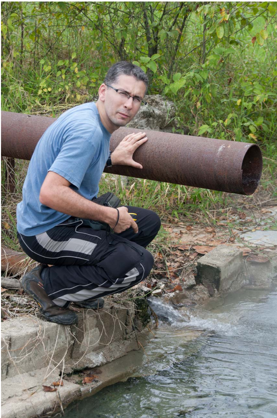
Detalle de la tubería donde brota artesianamente el agua termal.
