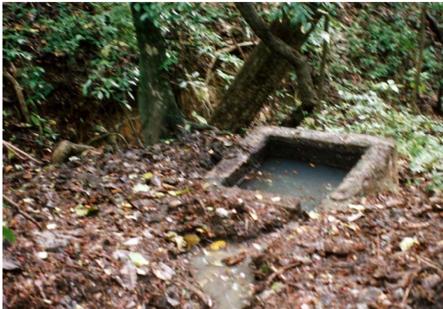
Fig. 8. Manantial Agua Negra. Tanquilla donde se almacena el agua.
