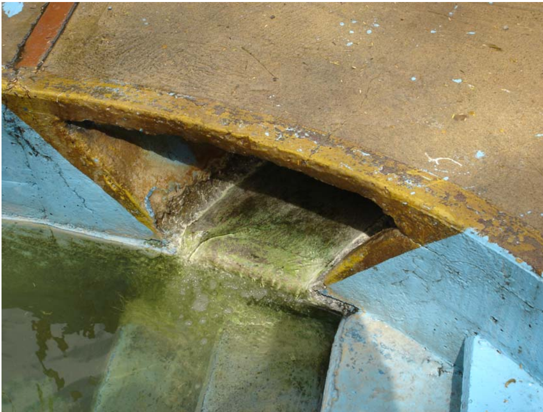
Paso del agua del manantial a la piscina
