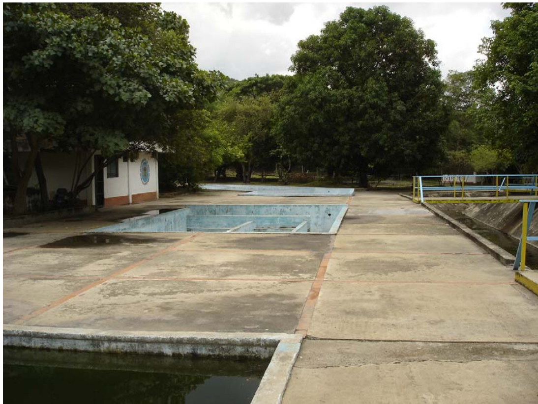
Vista de la segunda piscina que se mantiene vacía, dado el mal cálculo del proyecto en vista del bajo flujo de agua.
