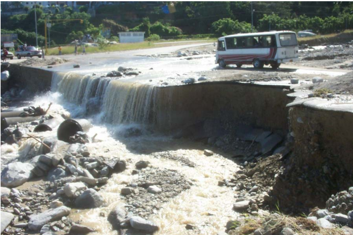
Figura 27: 11 de febrero. Efectos sobre la vía. Nótese los tubos que estaban debajo de la vía, como canalizadores del paso de las aguas, expulsados por la corriente. Fotografía: Rogelio Altez.
