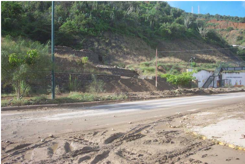
Figura 52: Muros de gavión que intentan contener deslizamientos en Camurí Chico. Imagen captada a principios de enero de 2005, a propósito de otras lluvias. Fotografía: Rogelio Altez.
