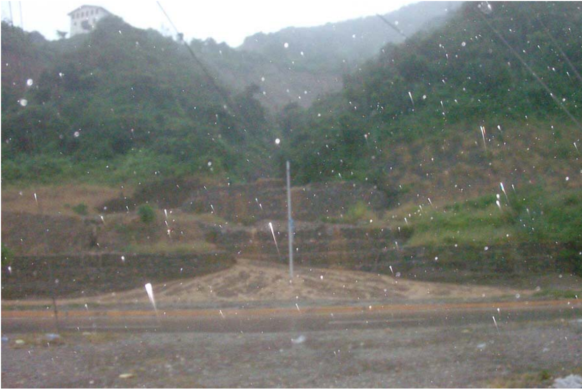
Figura 53: Los mismos muros de gavi3n, captados el 8 de febrero de 2005. Fotografía: Rogelio Altez.
