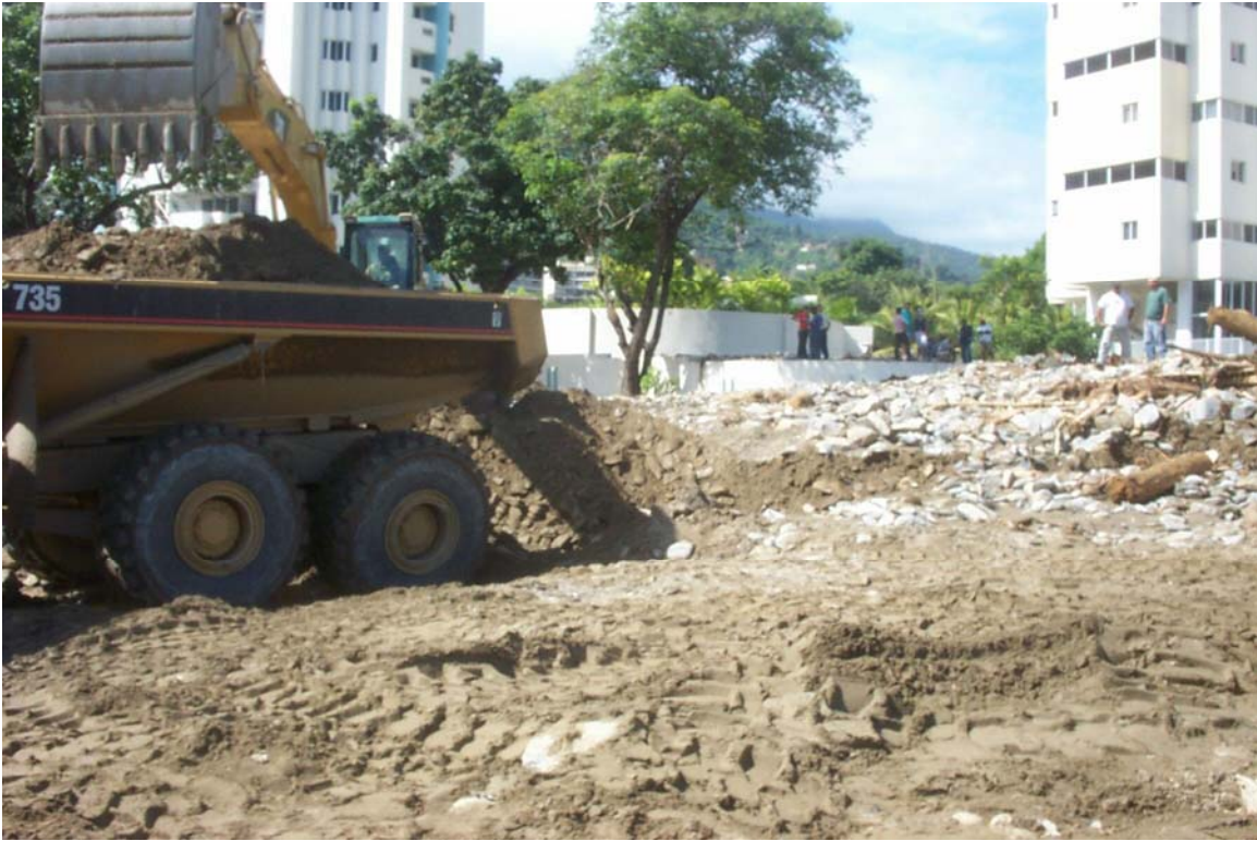
Figura 35: Remoción de sedimentos en la vialidad de Tanaguarena afectada por Quebrada Seca. 11 de febrero. Fotografía: Rogelio Altez.
