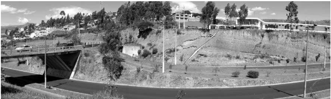
FIG. 5.5.3.6. Corte de la estructura de Conocoto, vista desde la autopista General Rumifahui. En la línea en blanco, se marca una falla que corta la colina y no es muy claro que corta los últimos centímetros de último nivel de suelo (Foto: M. Segovia).
