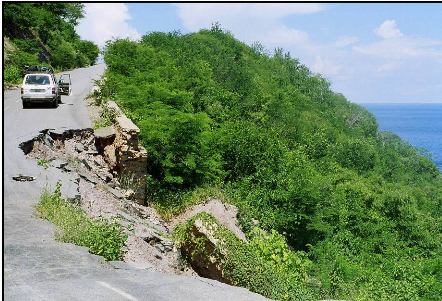
Figura 1.1 Vía de acceso hacia Puerto Hierro y su estado actual. Muros de contención mal diseñados, en virtud del carácter desfavorable de la foliación y de la pendiente del talud, determinan la ocurrencia constante de deslizamientos gravitacionales.
