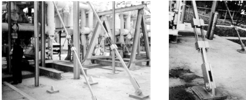
Figura 2-9: Sub-estación encapsulada de alto voltaje. Derecha: detalle del tensor. (Fuente: Coral 83, 1998).
