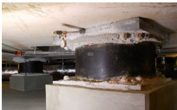
Figura 6-7: Aislador instalado en la base de un edificio. (Ref Kelly 2013)
