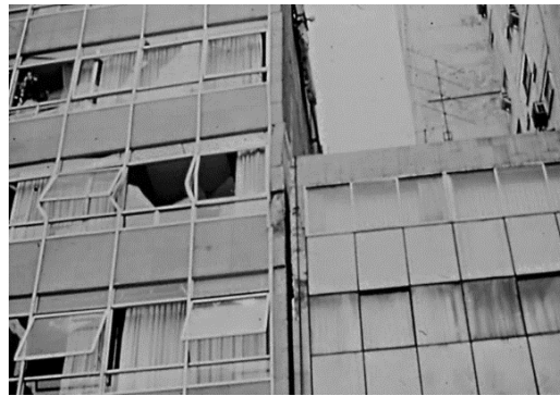
Figura 5-3: Deformación Fachadas de edificio de oficinas en la Ciudad de México 1985. (Autor: Centeno Werner, 21 de septiembre de 1985).
