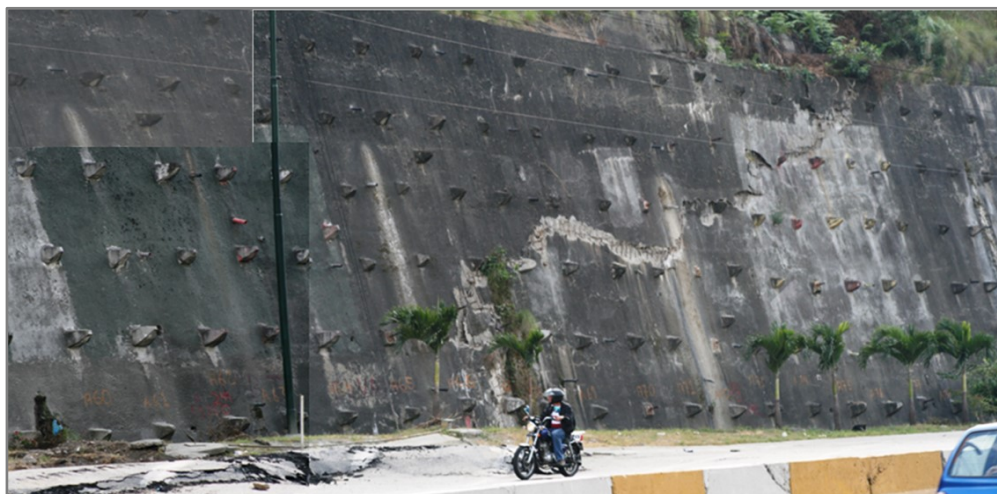
Figura 7-4: Falla en el Kilómetro N° 1 de la Autopista Caracas - La Guaira. (Autor: Páez-Pumar, 2011).
