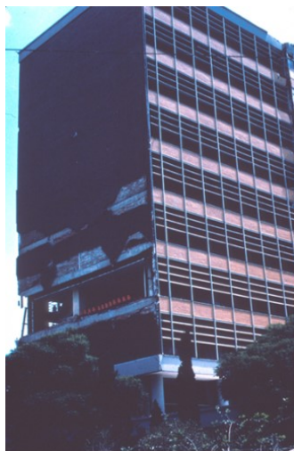
Figura 6-3: Hospital del Seguro Social dañado por el terremoto de México, 1985. 33
