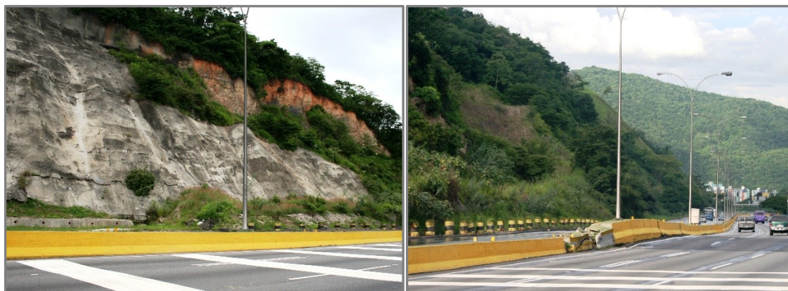
Figura 7-7 a): Grietas en la pantalla y deslizamiento del talud. Figura 7-7 b) : Grietas y levantamiento de la isla central. Ubicación: Kilómetro 5 de la AGMA, frente a Parque Caiza. (Autor: Páez-Pumar, 2017).
