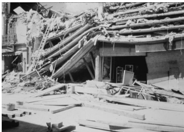
Figura 5-7: Colapso de la estructura del Hospital Benito Juárez en Ciudad de México en 1985. Fueron rescatados infantes en áreas confinadas en sus cunas metálicas resistentes a impactos. (Autor: Centeno Werner, 21 de septiembre de 1985).
