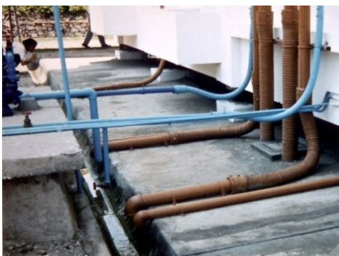
Figura 6-12: Tuberías y dispositivos flexibles para permitir movimientos de los edificios con aislamiento sísmico. (Fuente: Kelly, 2013).
