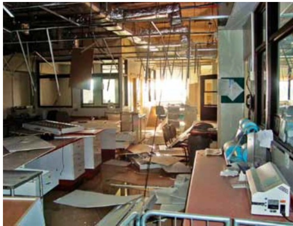
Figura 6-5: Hospital con daños no estructurales, terremoto de Chile 2010. (EERI, 2010)
