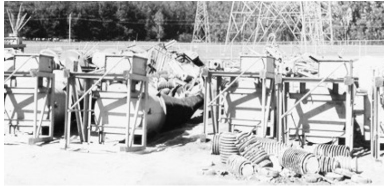
Figura 2-8: Estado final de la instalación, luego del sismo de 1989. (Fuente: propia).
