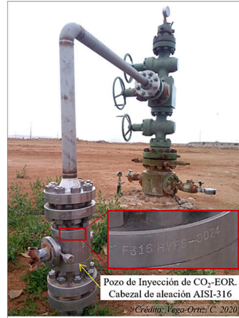
Figura 10. Pozo inyector de \text{CO}_2 , equipado con cabezal de aleación AISI 316 para resistir la corrosión en condiciones propias de EOR- \text{CO}_2 .
